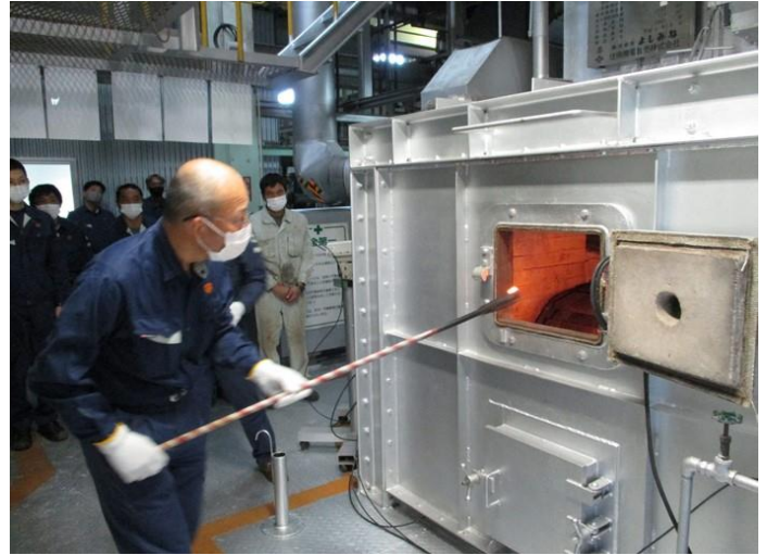
ボイラーへの火入れ (前田社長)
